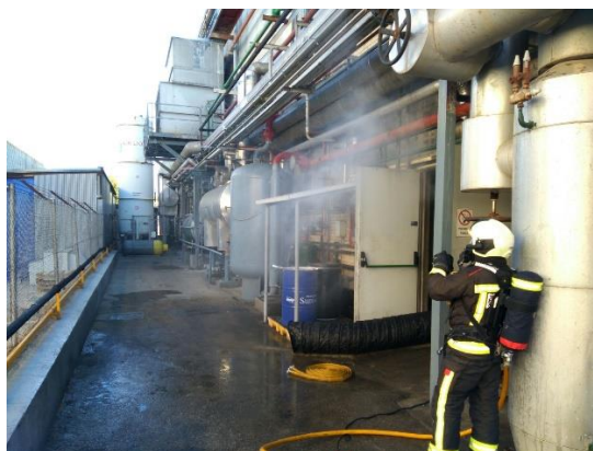
Pulverización de agua en fuga de amoniaco Fuente: M.Albaladejo
