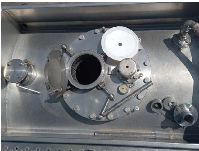
Imagen 32. Boca de hombre de una cisterna de H_2O_2 con válvula de seguridad y de venteo.
