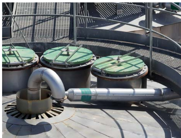
Imagen 19. Parasol superior y tubería de refrigeración en un tanque vertical.
