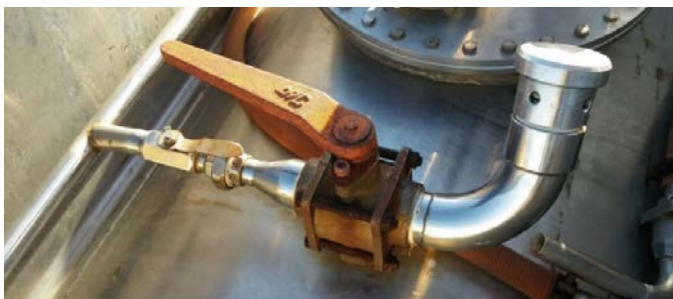
Imagen 23. Válvula de aireación para sobrepresión en cisterna de \text{H}_2\text{O}_2 .
