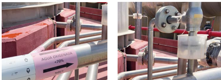
Imagen 20. Conducciones, válvula sobrepresión y cubeto.
