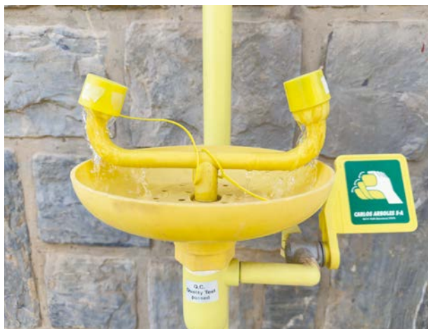
Imagen 52. Ducha y lavaojos en instalación con peróxido de hidrógeno.
