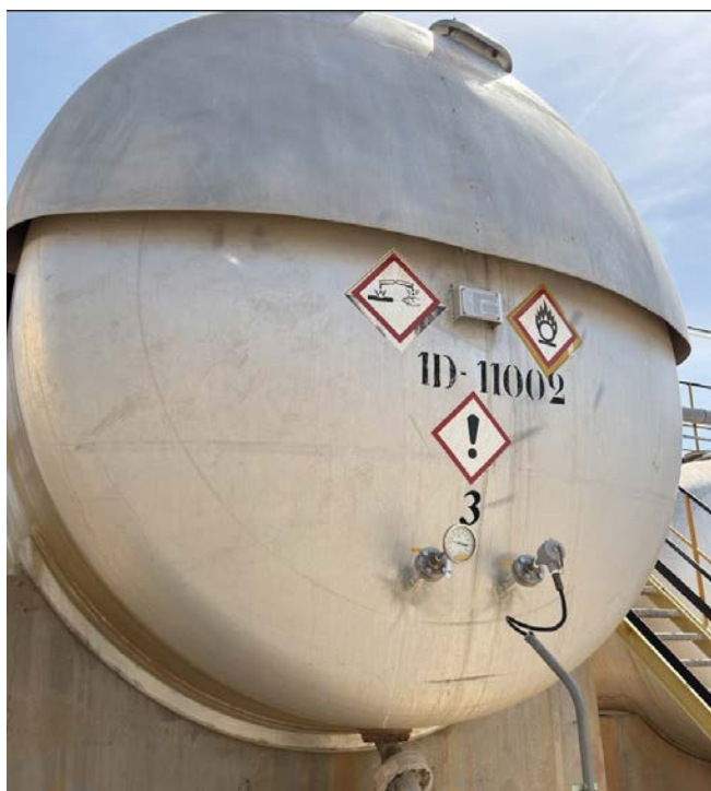
Imagen 44bis. Sensores de temperatura en la parte inferior del depósito de almacenamiento de H 2 O 2 .
