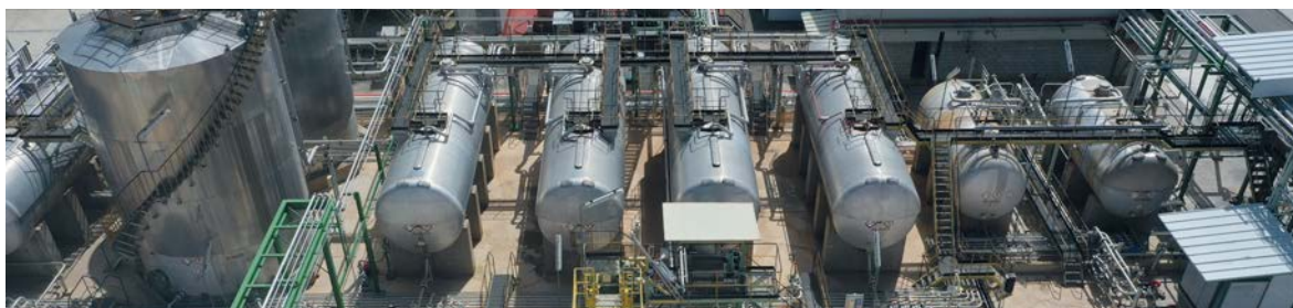
Imagen 14. Depósitos de almacenamiento de H_2O_2 .
